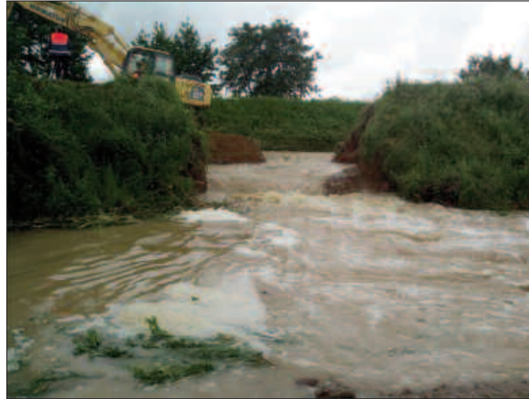
La rottura dell'argine della Mucchia e l'inizio dei lavori di riparazione (foto Claudio Goti)
