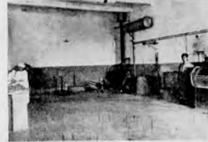
Ospedale - Nuovo impianto di lavanderia e sterilizzatrice
